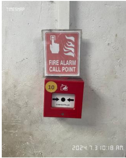
13.Fire alarm call point.JPG
